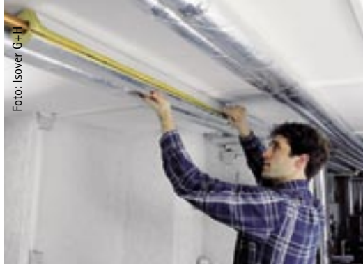
Laut Vorgaben der EnEV müssen nicht isolierte Warmwasserrohre gedämmt werden.
